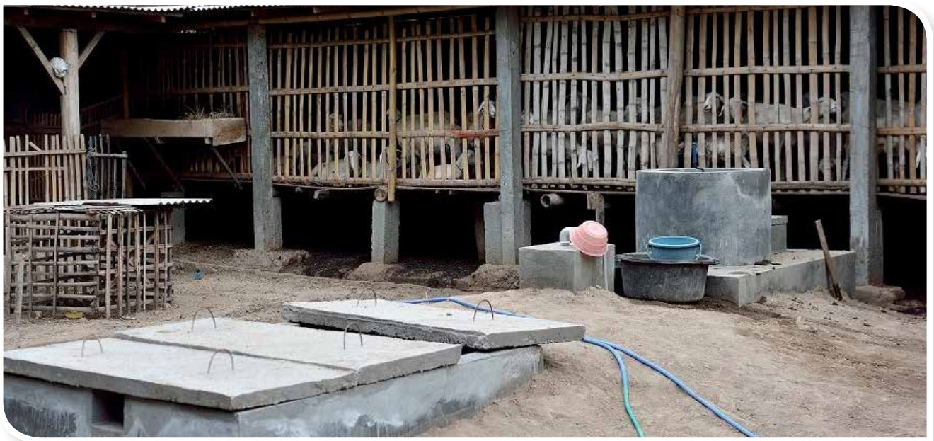
Reaktor biogas di kandang kambing Lokasi : Ngancar - Kediri
