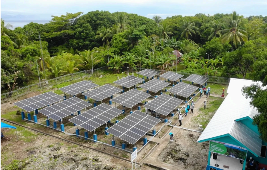
Gambar 9. PLTS komunal di sebuah lahan. Rumah di sebelah kanan gambar adalah tempat bagi komponen PLTS seperti inverter, solar charge controller, dan baterai 9
